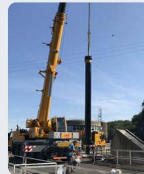
Maintenance vérin prise d'eau
